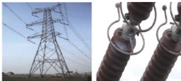
(a)故障塔全景 (b)绝缘子招弧角放电痕迹
